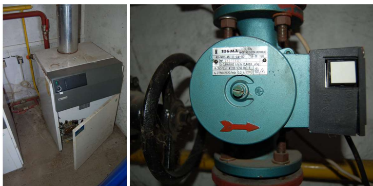
Obr. 2: Plynové kotly, kotlové čerpadlo
