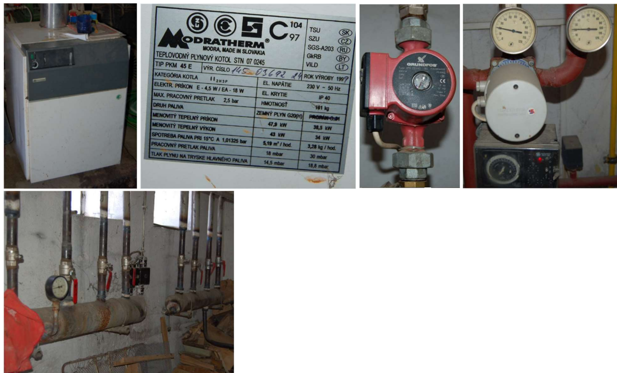
Obr. 2: Pôvodný plynový stacionárny kotol, čerpadlo a trojcestný zmiešavací ventil so servopohonom, rozdeľovač a zberač.
