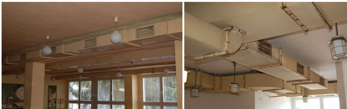
Obr. 11: Rozvody nefunkčnej VZT v jedálni a v kuchyni
