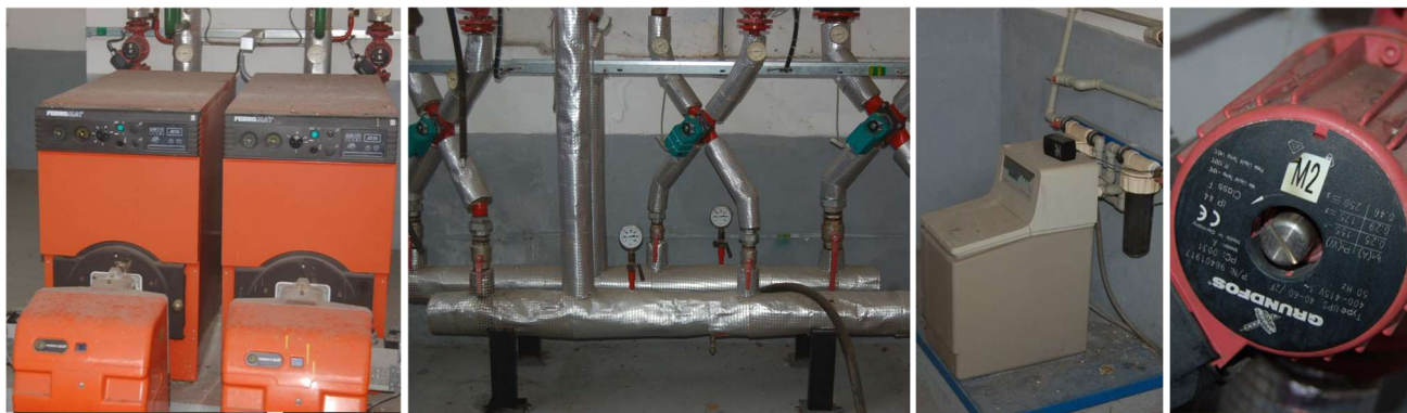
Obr. 2: Plynové stacionárne kotle FERROMAT, rozdeľovač a zberač, úprava vody a kotlové čerpadlá.
